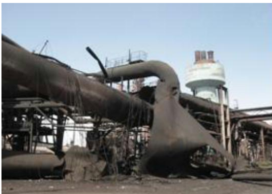
落下物による破損
