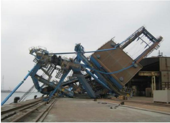
漂流船により損傷を受けた岸壁
